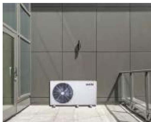
RISCALDAMENTO CON POMPA DI CALORE
